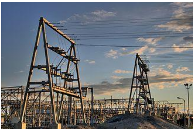
Subestação próximo de Yellowknife, Canadá.
