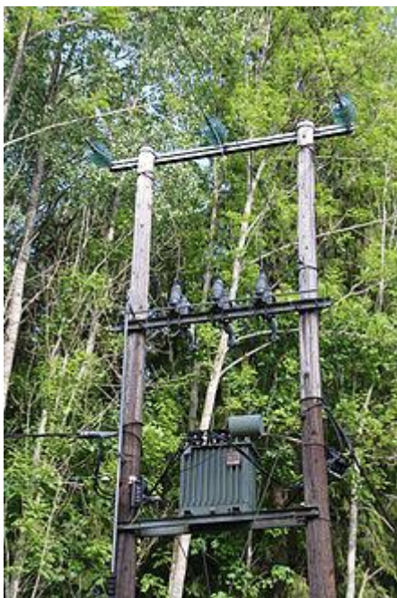
Um PT aéreo com transformador de distribuição trifásico de 23kV/240V
