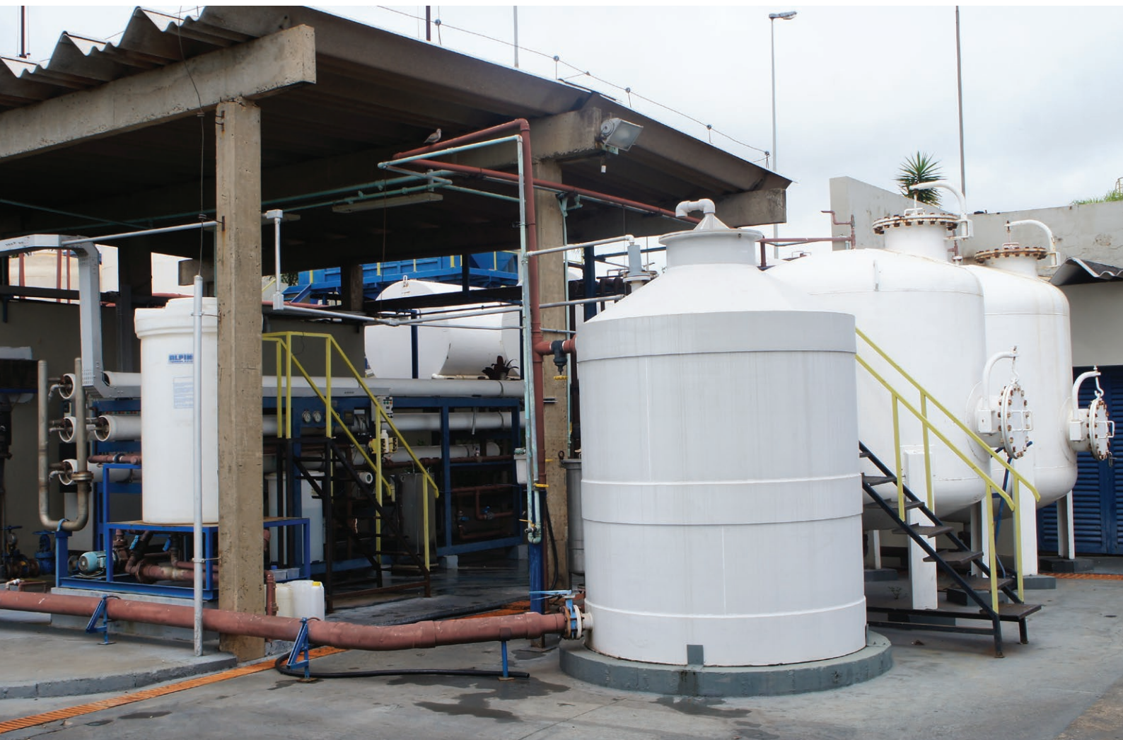
ESTAÇÃO DE TRATAMENTO DE EFLUENTE INDUSTRIAL (ETE), localizada na Planta 2 da Tecumseh
